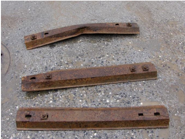
Die Schwellen nach 40 Jahren in der Erde Bild: Remo Hartmann
