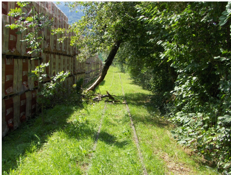
Der abgebrochene Ast über dem Gleis Bild: Remo Hartmann
